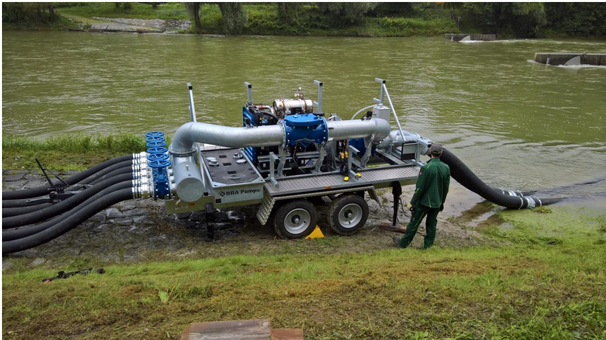
Abbildung 1: Hochwasserpumpe in Betrieb; rechts 2 Ansaugschläuche, links 6 Ableitungsschläuche
